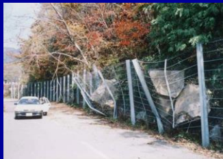
岩手県内陸北部地震(平成10年)
