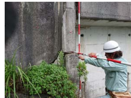
地すべりによる前傾する擁壁
