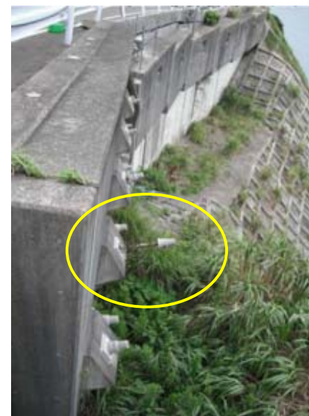
抜け出したグラウンドアンカー
