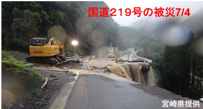
土砂流入による排水暗渠閉塞に起因する道路崩壊（R219：宮崎・西米良村）
