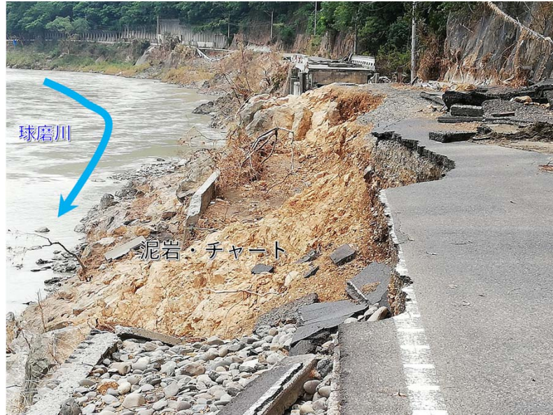
越流水による侵食崩壊（R219：熊本・坂本町）
