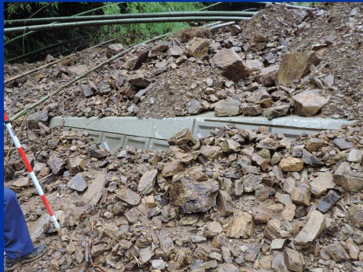
細粒分は流出し岩塊主体の土塊が堆積している
