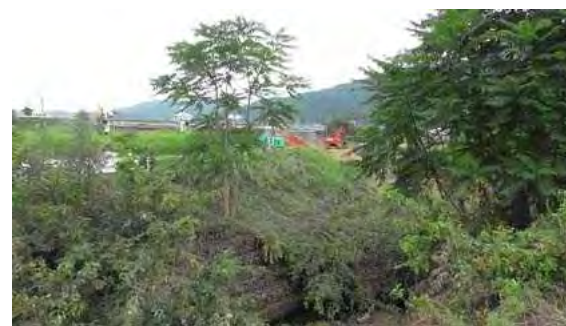
合流部分の決壊箇所
