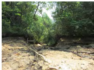
越流破堤箇所
