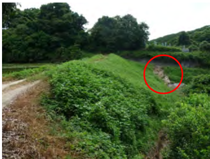
洪水吐下流水路の越流による法面崩壊
