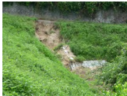
水路が左に曲がる少し手前で崩落
